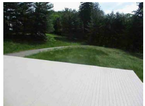
Deck (Fall Hazard)
